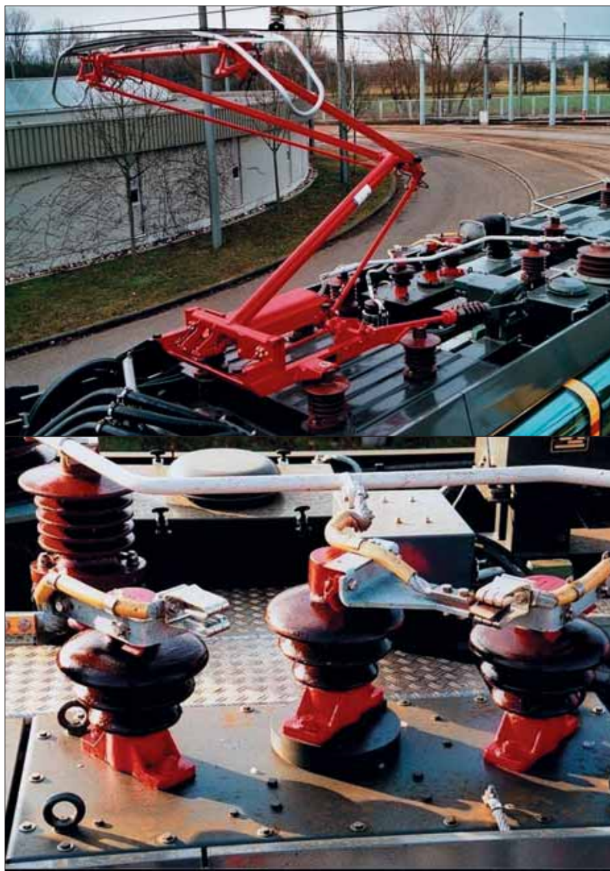
Oben: Dach eines Zweisystemfahrzeugs mit Spannungswandler sowie Systemwahlschalter, der beim Befahren des Systemwechsels automatisch auf die andere Spannung umschaltet
